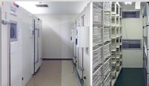
恒温恒湿室(7室)・恒温室(2室)
